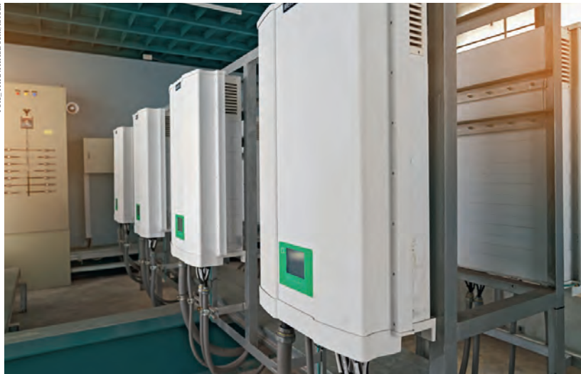
Es lohnt sich, den erzeugten Solarstrom möglichst selber zu verbrauchen. Speicherbatterien und intelligente Steuerungen helfen dabei. Im Bild: Solarwechselrichter
